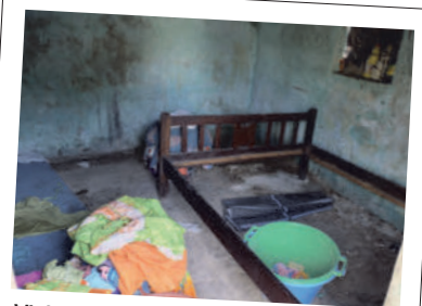
Viele Zimmer befinden sich in unzumutbarem Zustand. Die Menschen schlafen auf Matten am Boden.
